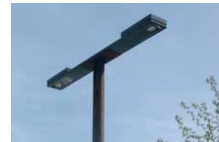
Réutilisation de rails pour l'éclairage public. Parking gare Grisolles (82)
